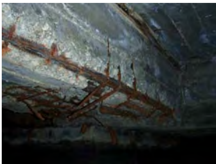
Figure 5-2 Korrozioni ne armaturen e traut mbajtes ne kalaten 10/11
